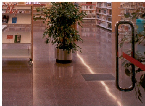
12.32 El disseny d'una peça de paviment coincident amb la caixa de connexió configura un acabat unitari.
